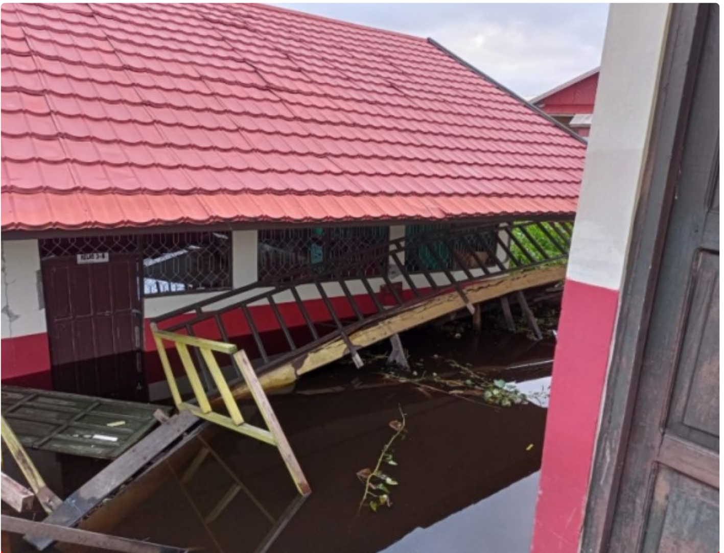
Bangunan SDN 14 Palangka Raya yang ambrok
